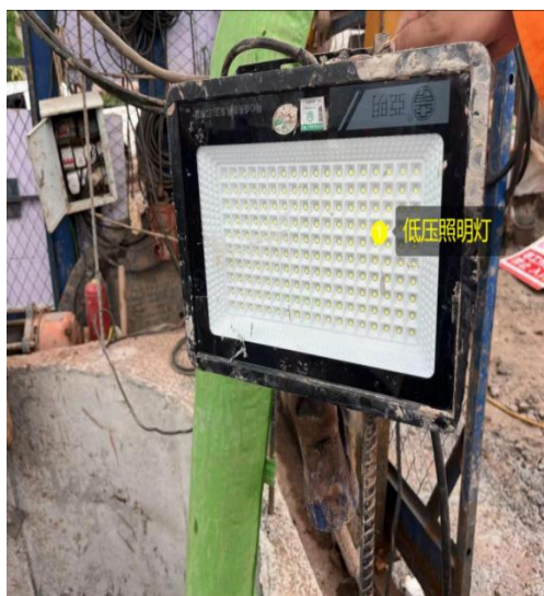
图 5 人工挖孔桩设置低压照明灯
