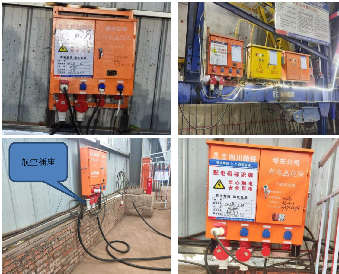
图2 配备装配式三级配电箱并上墙
