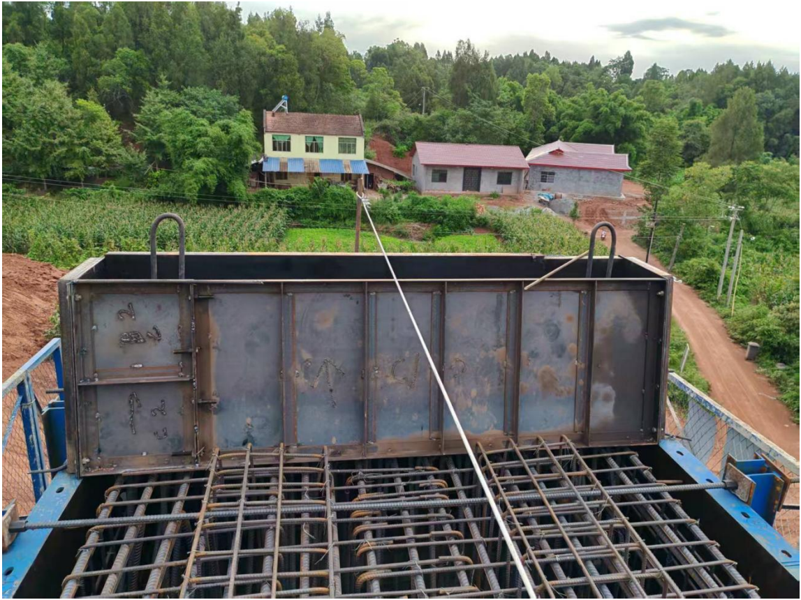
图 1 挡块模板与盖梁侧模刚性连接
